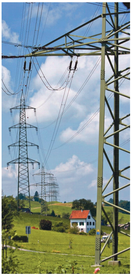
Auch wegen des Landschaftsschutzes sind Freileitungen umstritten. Foto: Key
