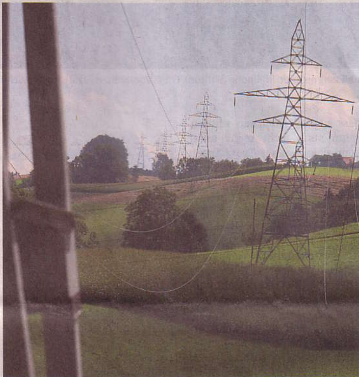
Geplanter Ausbau: Die bestehende Stromleitung – hier bei Niedermuhlern – soll durch eine neue mit höheren Masten ersetzt werden.
