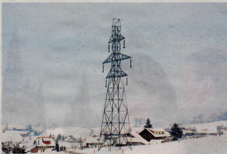
Die BKW plante bisher mit oberirdischen Hochspannungsleitungen.
